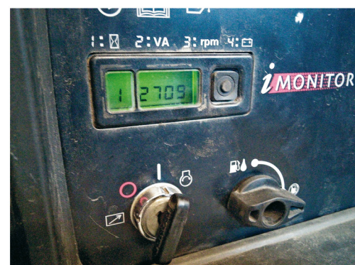
Agregat prądotwórczy Honda EM65iS – po przepracowaniu 2709 godzin – po naprawie wrócił do właściciela!
